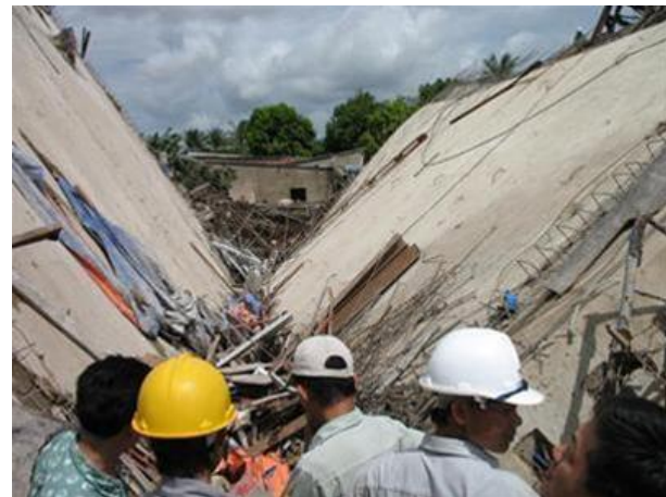
Đường gãy của dầm bê tông giữa trụ P13 và P14 (Ảnh: Sáu Nghệ)
